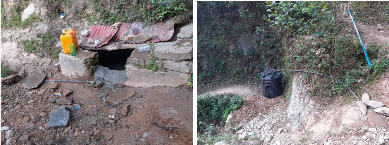
Foto 5: sistema di sfioro e tank di raccolta acque di sfioro provenienti dall'attuale sorgente
