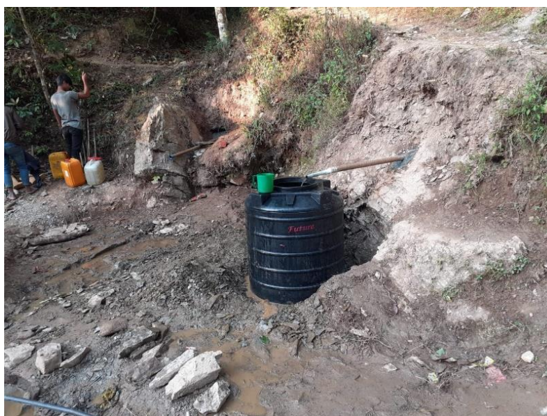
Foto 4: tank installato in corrispondenza del drenaggio n. 4
