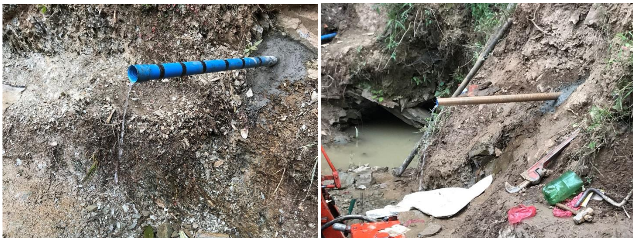
Foto 3: fuoriuscita di acqua dai fori di drenaggio
